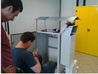
Configurazione Cabinet esterno e unità di raffreddamento
