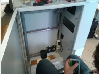
Installazione pompe di aspirazione
